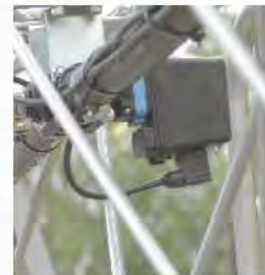
Corte de 5 secciones con válvulas eléctricas manual o automático.
